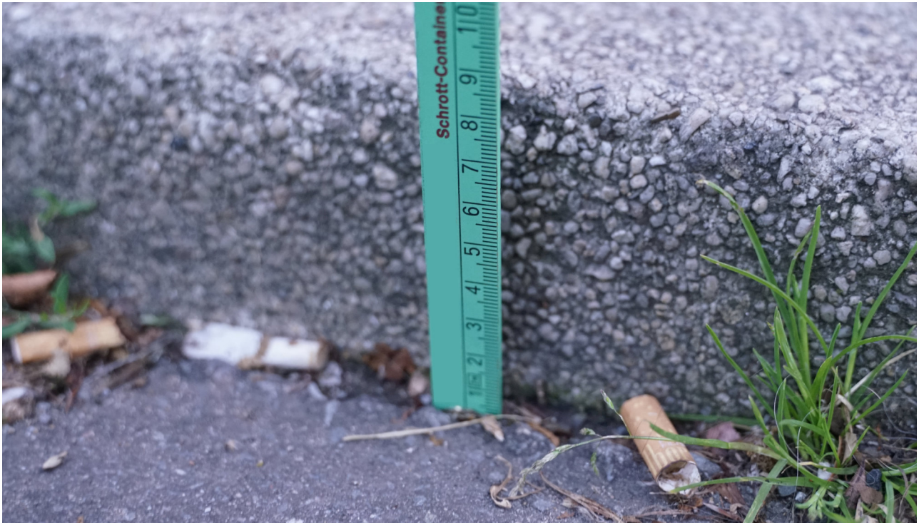
Bild 2: Angrenzende Fußgängerfurt mit Bordsteinhöhe zwischen 8 und 9 cm hoch.
