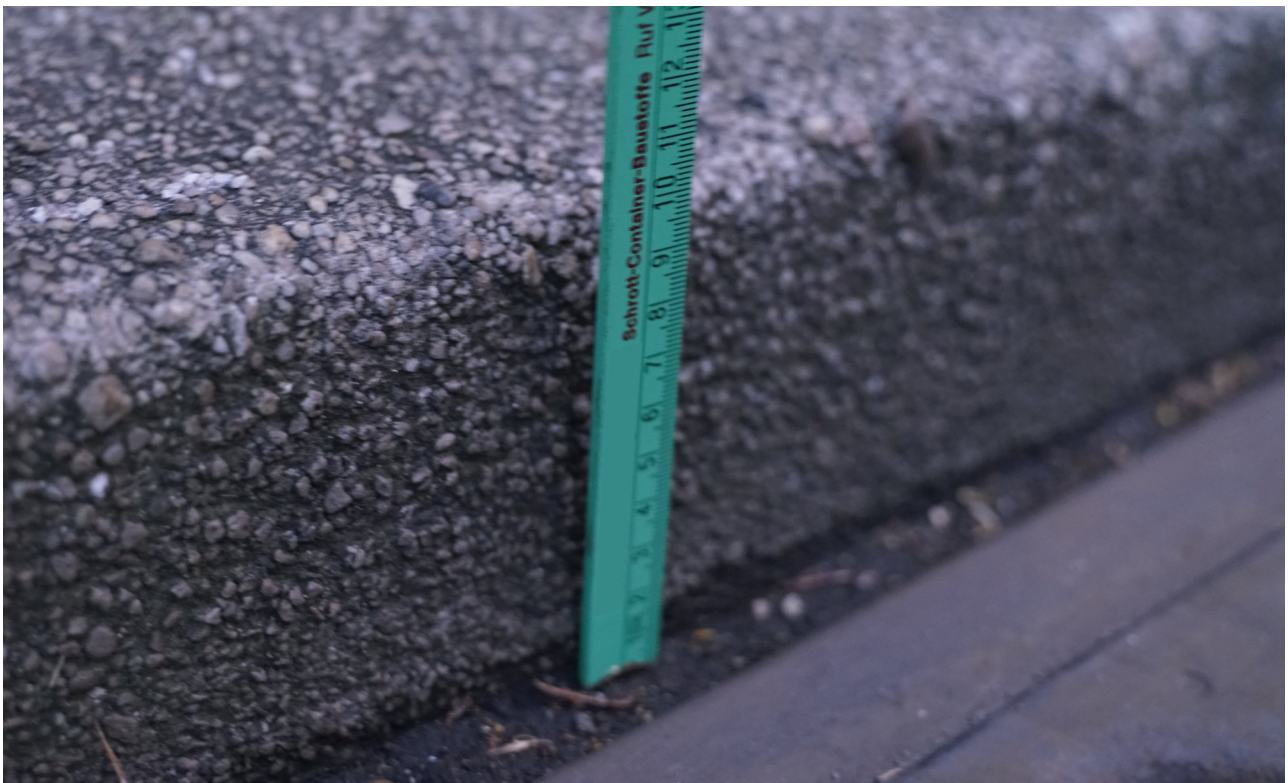
Bild 3: Westlicher Bordstein der Briller Straße im Bereich der Fußgängerfurt zwischen 9 und 10 cm hoch.
