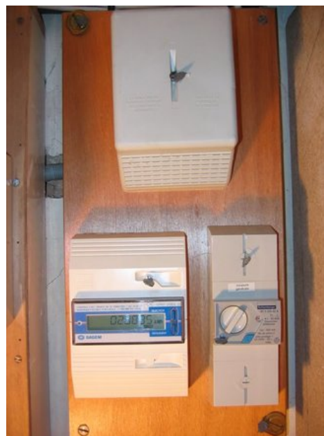
afb.13.1.1 - 3 Moderne elektronische meter met hoofdschakelaar
