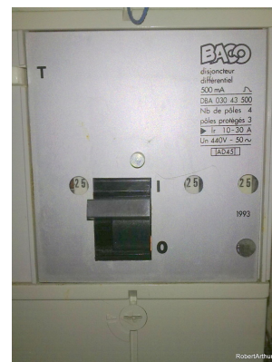
13.1.2-3 Een wat oudere triphasé hoofdschakelaar. Duidelijk is te zien hoeveel ampère er per fase maximaal binnenkomt.
