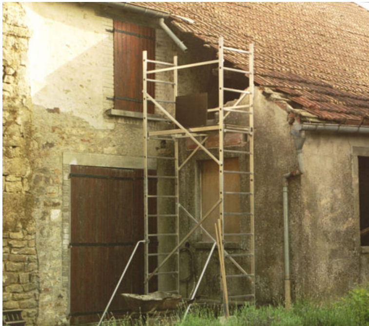
afb. 20.3 - 9 Buiten met opgezette tweede verdieping. Het luik is opengeklat, want u beklimt de steiger steeds aan de binnenkant, nooit buiten! Of gebruik een ladder naast de steiger zoals op afbeelding 8.
