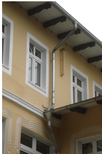
afb. 10.2.2 - 8 Goed bedoeld maar slecht gedaan! -> Oh no, a soil stack vent ending under a protruding roof!
