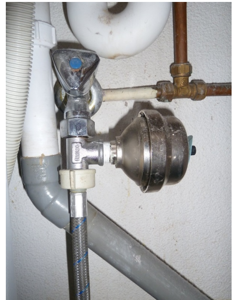
afb.10.1.5 - 5 Flamco waterslagdemper aangesloten aan de stopkraan van een wasmachine. Foto R.v.d.Meulen
