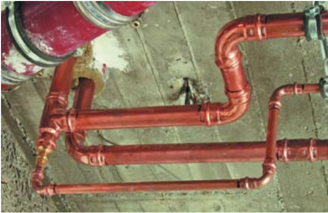
Blick auf eine im Rahmen einer Sanierungsmaßnahme erstellten Inliner-Installation mit Kupferrohr: Erkennbar ist der Platzgewinn, weil auf den zweiten Steigestrang verzichtet werden konnte
